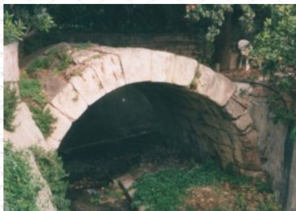
Ponti romani a S. Marinella. Ponte delle Vignacce, situato all'altezza del km 62,300, ad una sola arcata in conci di arenaria. (Archivio GATC)
